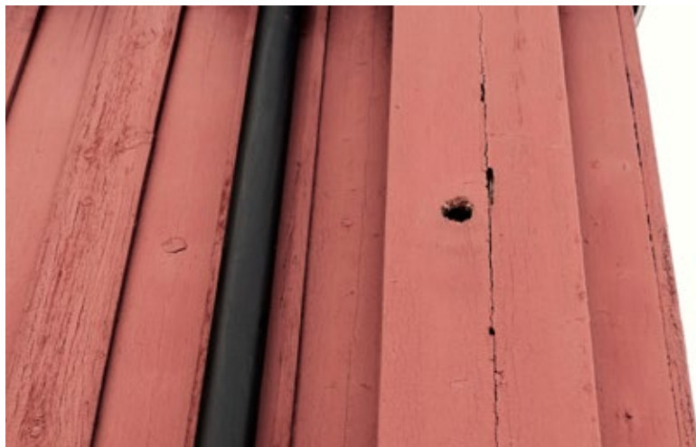
Hakkespettene har laget rundt 25 hull i kirkefasaden.
